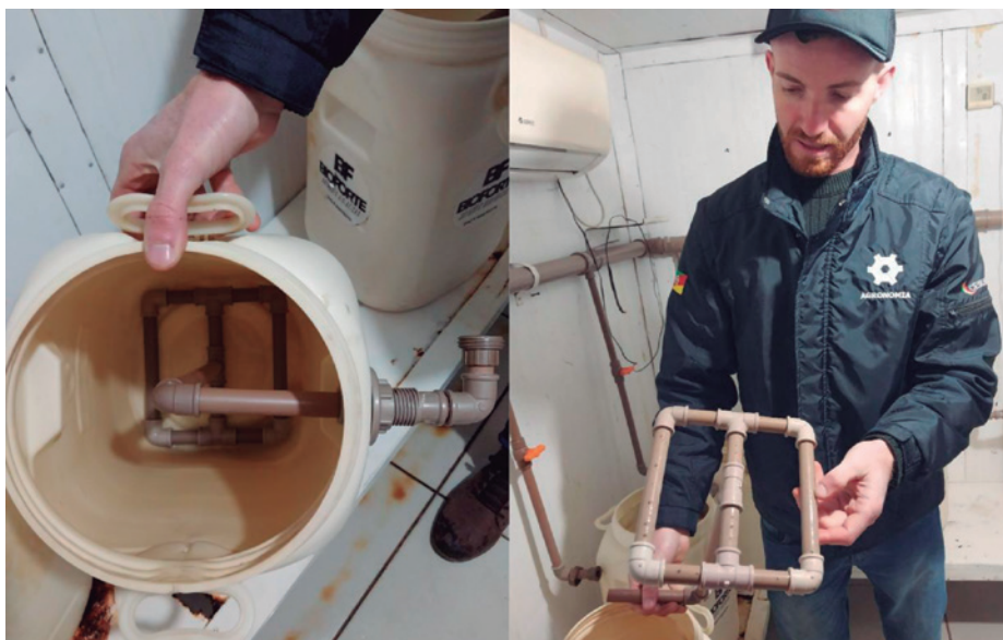
Ronaldo mostra um aerador que se utiliza no interior do biorreator, 2025
