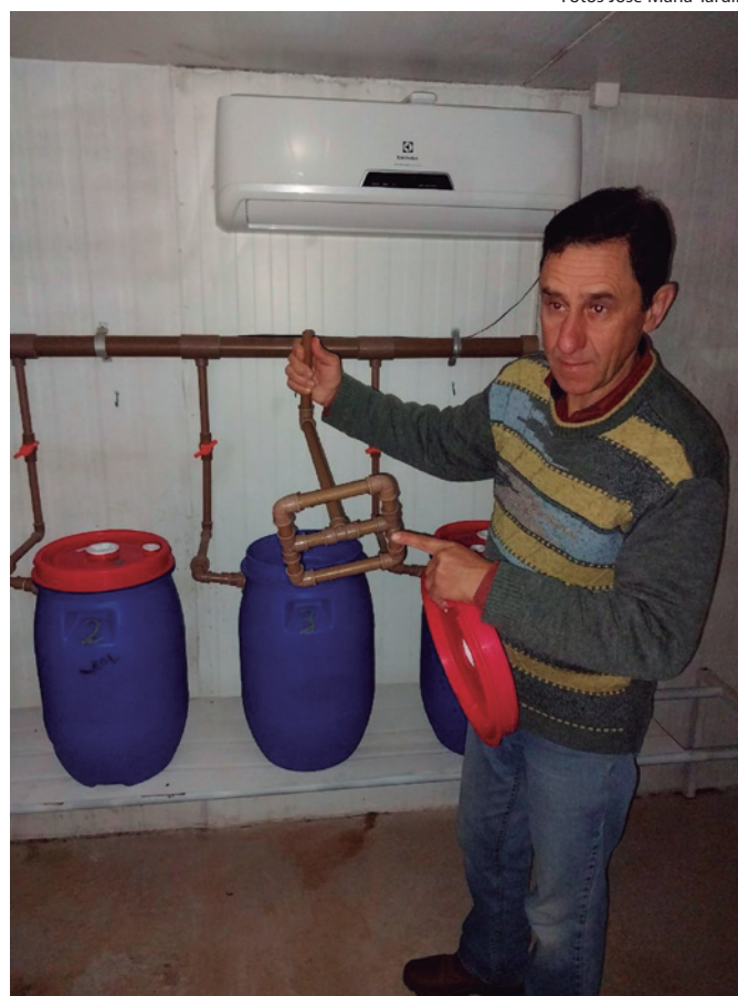
Aerador que se instala no interior da bombona composta o biorreator, 2025
