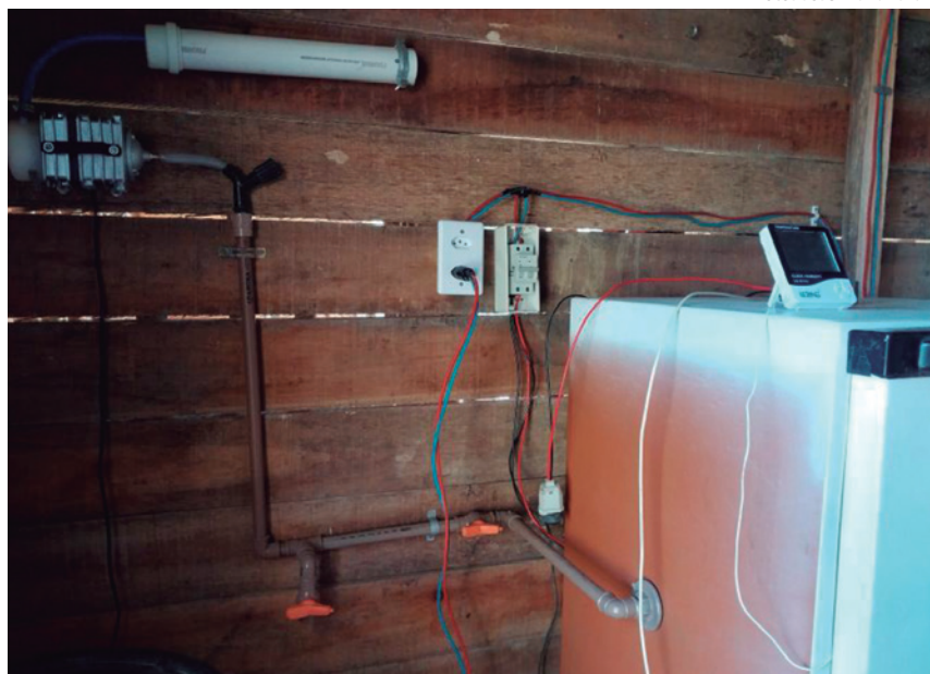
Compressor de ar para aeração do biorreator e sensor de temperatura, 2025
